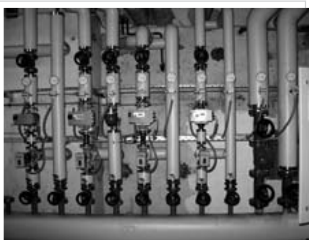
Neuer Heizungsverteiler mit Kieback + Peter DDC 3000 Unterstation
